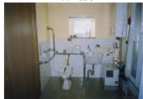
図10 車いす用トイレ
