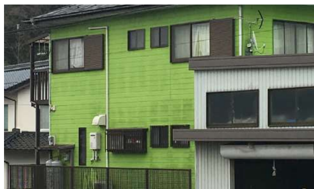
写真 1-2 外壁面での藻類の発生の様子
