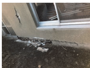
図 3-7 2階南壁の鉄筋腐食、露出
