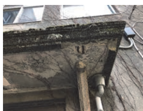
図 3-6 学生用玄関（入隅部）の底底部の鉄筋腐食、露出
