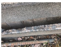
図 3-3 南面外壁の仕上げ剥落部分を上から見た様子
