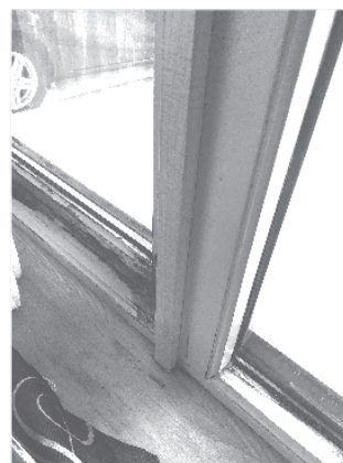
写真2-1 窓周りの劣化
