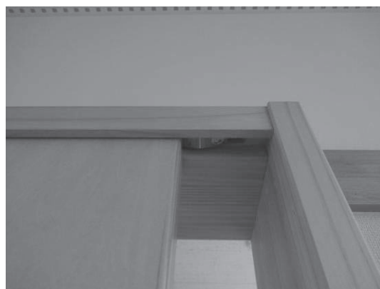
写真 3-7 フラットレール用ストッパーの位置で 扉がいったん止まるようになっている
