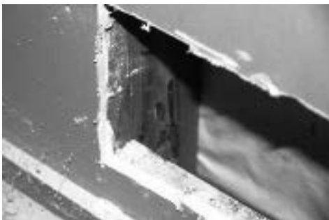
写真 5-2 はく離した壁内部の様子
