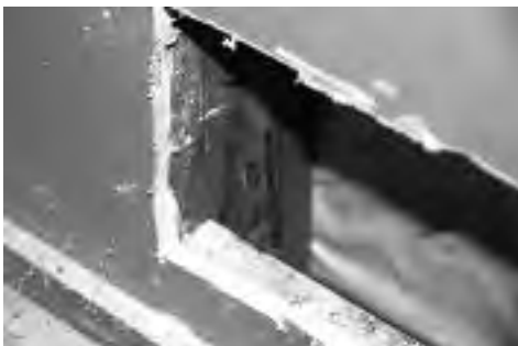
写真 5-2 はく離した壁内部の様子
