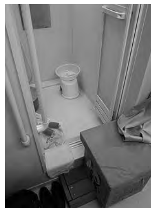
写真5-1 仮設住宅の浴室の段差（事例7）
