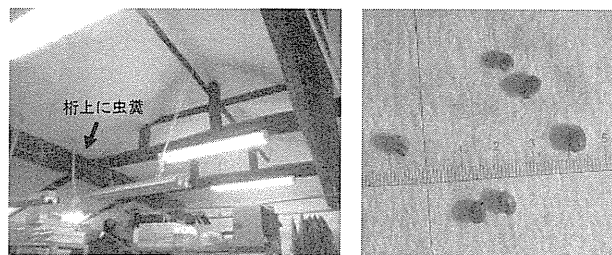
写真 2-6 二階作業場と桁上で発見された虫糞
