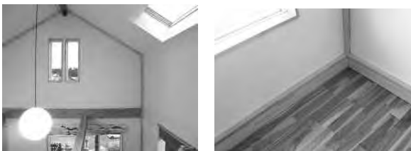
図 8-3 「SI分離棟」の見切り配線(左:廻縁 右:幅木)
