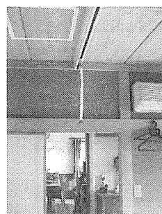
和室からリビングへは、リフターを2回付け替えなければならない。
