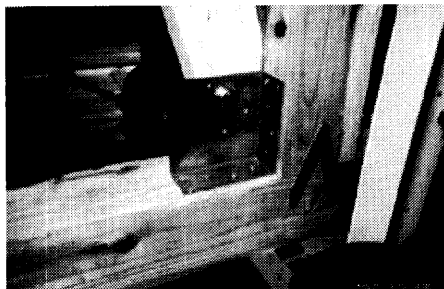
写真7-6 わずかに抜けた箱型筋違い金物の木ネジ
